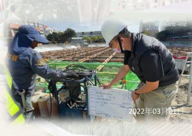
支撐預壓力抽查
